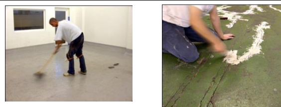
Pic 2. Balayer le plancher, enlever les points forts et de réparation patch ou le niveau des fissures ou des points faibles..
